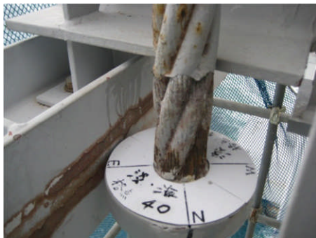
写真-1 ロープ定着部の腐食
