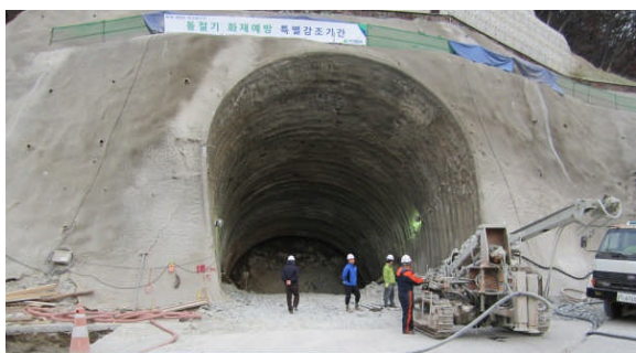
写真-10 トンネルアンカレイジの掘削 Photo-10 Excavation for Tunnel Type Anchorage
