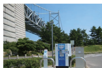
EV 充電設備
