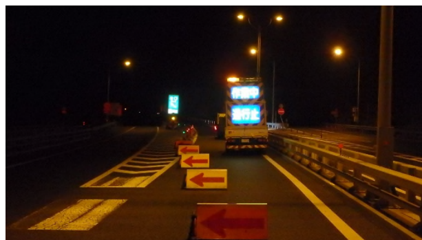
規制車による通行止め状況
