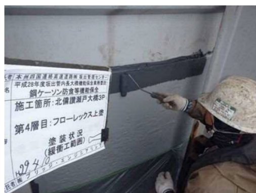
飛沫・干満帯の塗装作業 (一般国道30号 北備讃瀬戸大橋3P)
