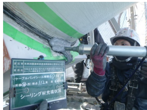
ケーブルバンドシール補修状況 (一般国道 30 号 南備讃瀬戸大橋)
