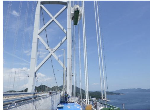
吊橋ハンガーロープの塗替塗装状況 (一般国道 317 号 因島大橋)
