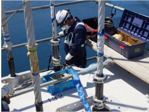
吊橋ハンガーロープ定着部の補修状況 (一般国道 28 号 大鳴門橋)
