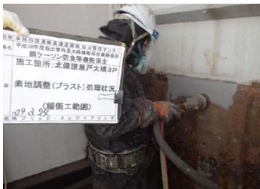
飛沫・干満帯の素地調整作業 (一般国道30号 北備讃瀬戸大橋3P)
