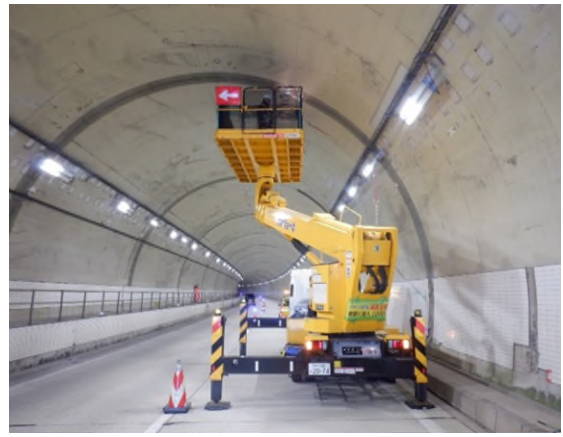
はく落対策（トンネル目地部）
