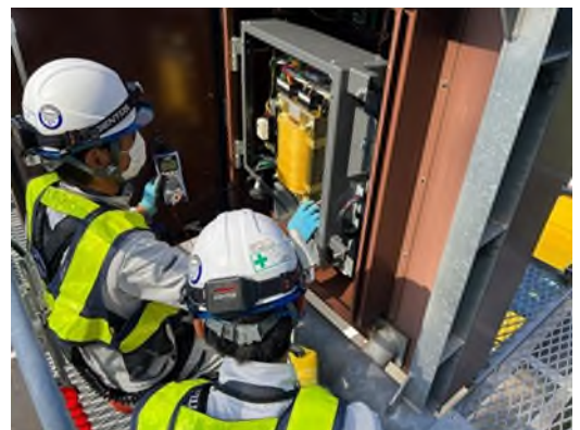
点検状況 (電気通信施設)
