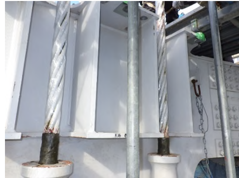
吊橋ハンガーロープの内部充填完了 (一般国道30号 瀬戸大橋)
