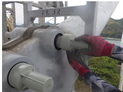
ケーブルバンドボルトキャップの交換 (一般国道 317 号 大島大橋)
