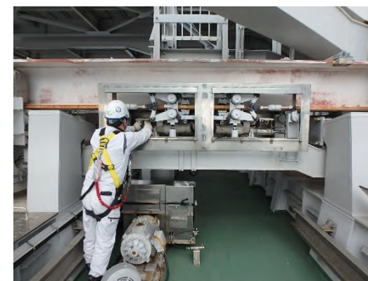
点検状況（機械設備）
