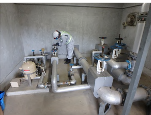
点検状況（機械設備）
