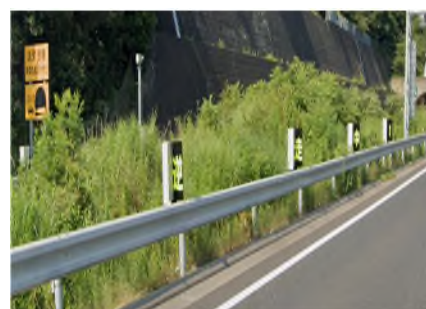
防眩式逆走注意喚起板 (逆走方向で「逆走中!」標示)
