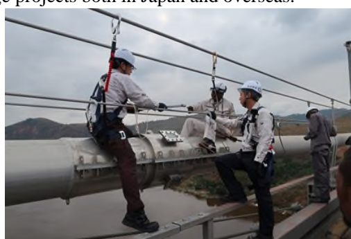
写真-7 JB 本四高速社員による点検状況 Photo 7 Inspection by HSBE's engineers
