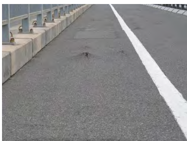
写真-1 プリスタリング状況(原自歩道) (Photo.1 Blistering)
