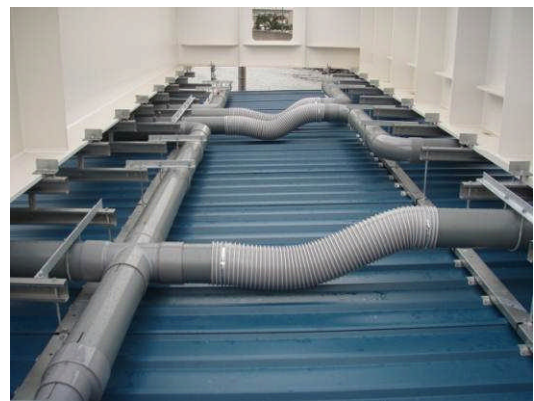
写真-6 除湿システムの配管
