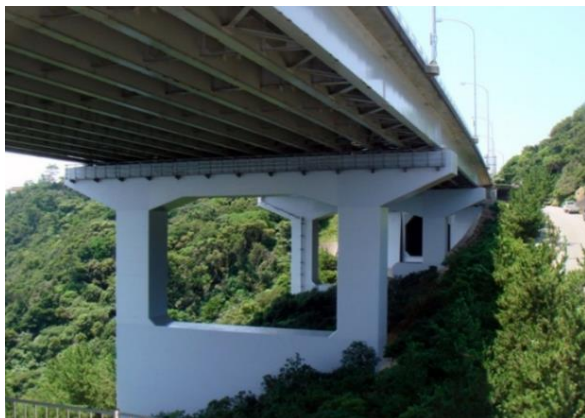
写真-1 現在の桁の状況
