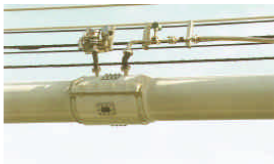
来島海峡大橋のケーブルと送気バンド New system at the Kurushima-Kaikyo Bridge
