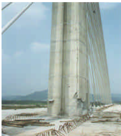
主塔のひび割れ Cracks of main tower
