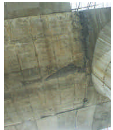
主桁の損傷状況 Breakage of main girder
