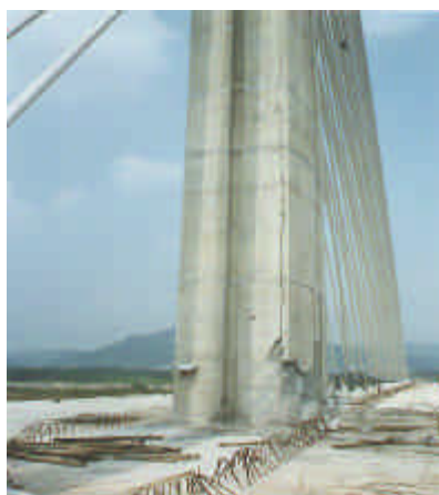
主塔のひび割れ Cracks of main tower
