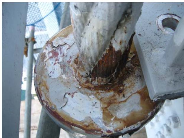
写真-3 ハンガーロープ定着部の腐食状況 (Photo.3 Corrosion on the anchor part of suspender)
