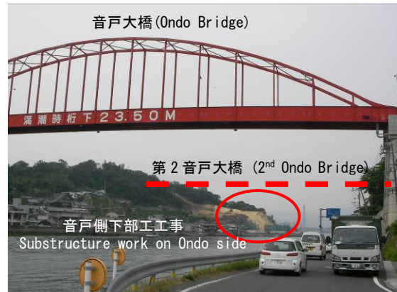
写真-6 第2音戸大橋の工事現況 (Photo.6 Construction status of the 2 nd Ondo Bridge)
