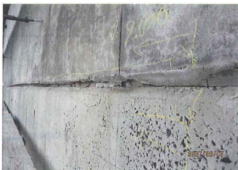
写真-1 目地部コンクリートの浮き
