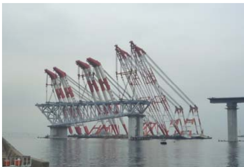
写真-5 東京港臨海大橋(仮称)のトラス桁架設 (Photo 5: Truss girder erection of Tokyo Bay Bridge)
