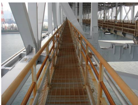
写真-4 管理路劣化状況
