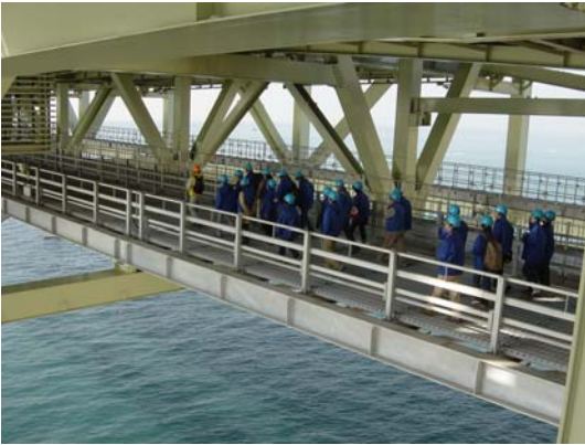
桁内管理路を歩行、格子状の床面から 足下の海が見える
