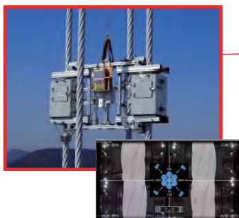
吊橋ハンガーロープ画像点検システム
