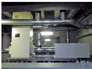
桁内の除湿設備（新尾道大橋）
