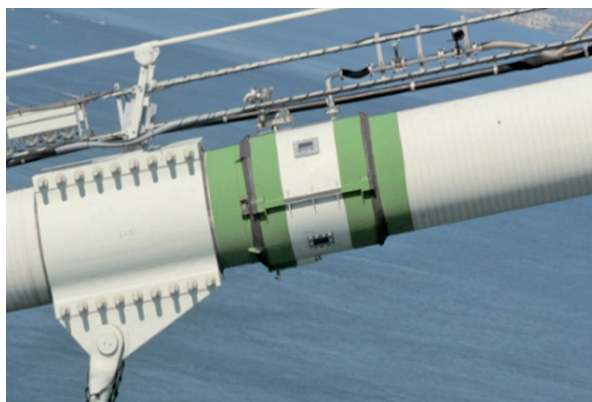
吊橋ケーブル送気乾燥システム
