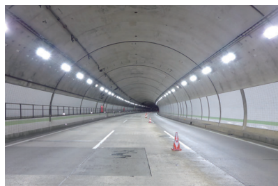
トンネル照明
