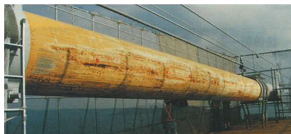
ケーブル腐食状況（従来のケーブル防食方法）
