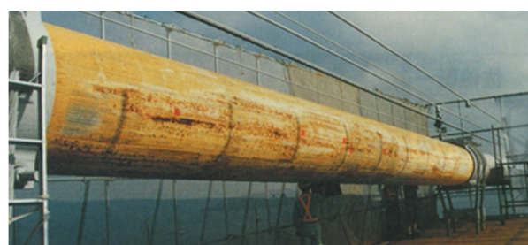
ケーブル腐食状況（従来のケーブル防食方法）
