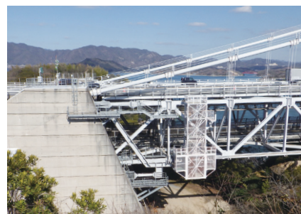
制震ダンパー [因島大橋/広島]
