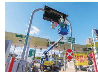
料金所設備のメンテナンス
