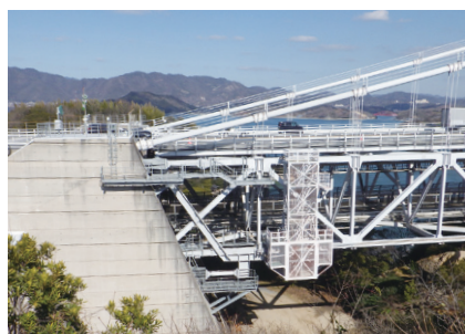
制震ダンパー [因島大橋/広島]
