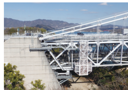
制震ダンパー [因島大橋/広島]
