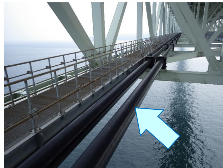
明石海峡大橋に設置されている2本の送水管
