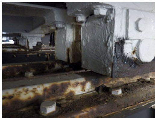
②大型伸縮装置の腐食状況
