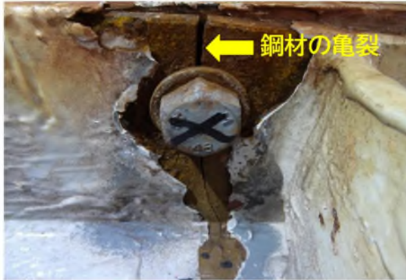
①伸縮装置の腐食状況（路面裏側）
