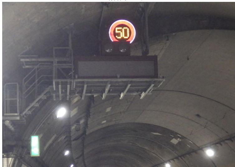
トンネル情報板（坑内）
