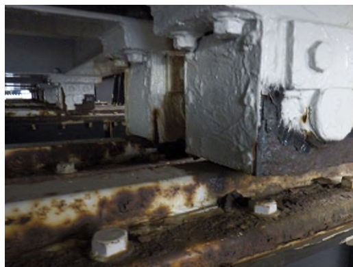
②大型伸縮装置の腐食状況
