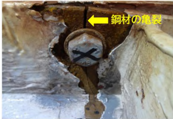
①伸縮装置の腐食状況（路面裏側）
