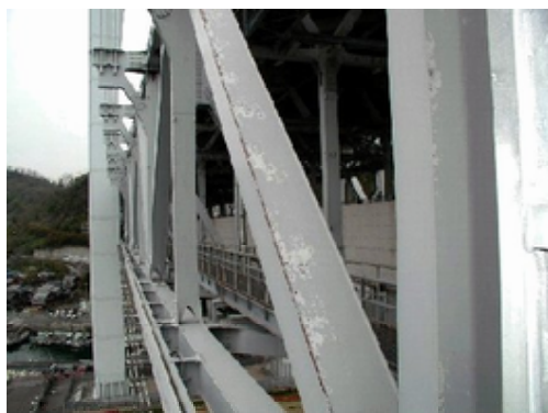
塗膜の劣化した部材
