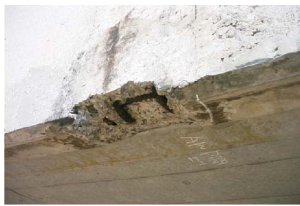
写真 コンクリート劣化状況
