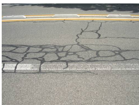
舗装補修前の路面状態 (一般国道317号 伯方島IC～大島北IC)
