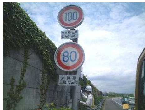
可変速度標識の点検状況 (一般国道 30 号 早島 IC～水島 IC)
