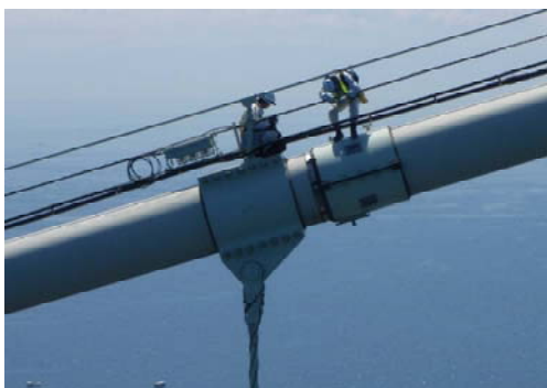
長大橋(吊橋ケーブル)点検状況 (一般国道 28 号 明石海峡大橋)
