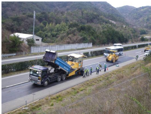
舗装補修状況 (一般国道28号 西淡三原IC~淡路島南IC間)
