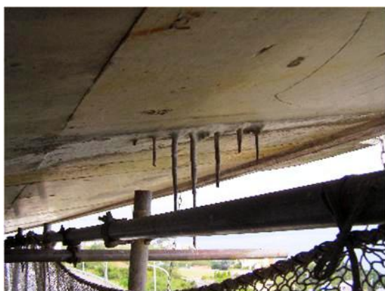
床版裏面に発生した遊離石灰のツララ
