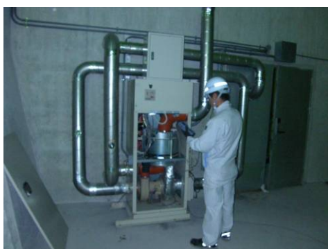
スプレー室除湿設備の点検状況 (一般国道 28 号 大鳴門橋)
