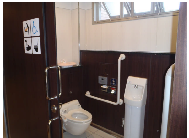
女子トイレ多目的ブース
