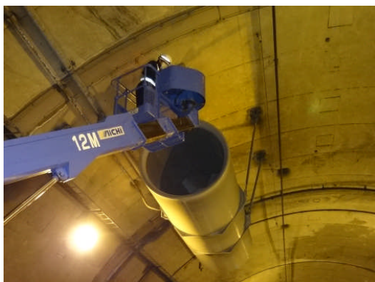
ジェットファン点検状況
