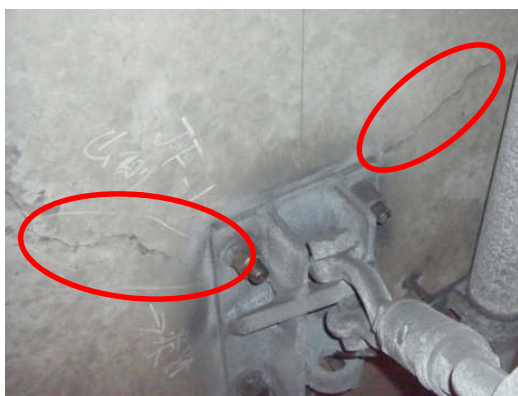
下り線ジェットファン 吊金具コンクリートのひび割れ状況
