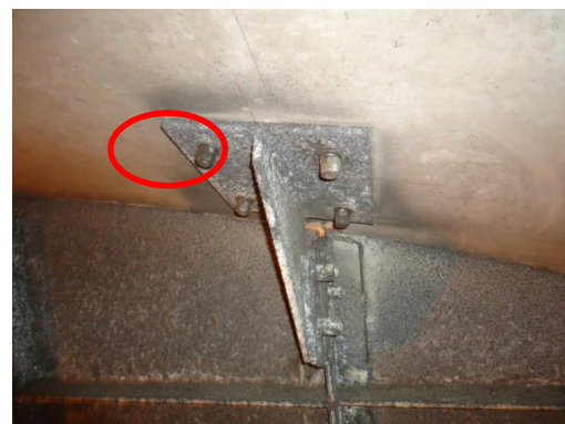
制風板アンカーボルト緩み（再締付済み）
