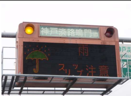
道路情報板（補修前）
