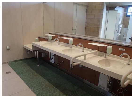
瀬戸田 PA トイレ洗面台
