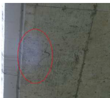
有城高架橋 床板の浮き 補修前
