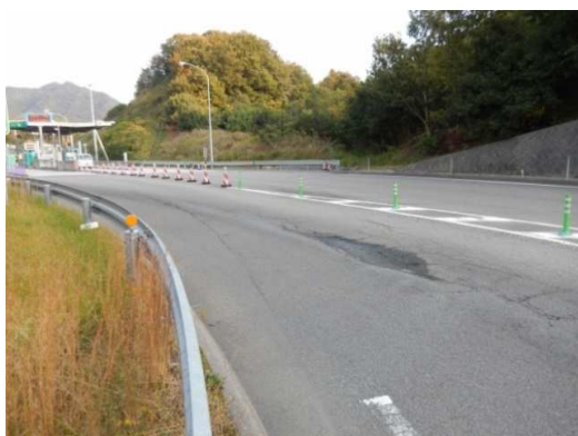
わだち掘れ（補修前）
