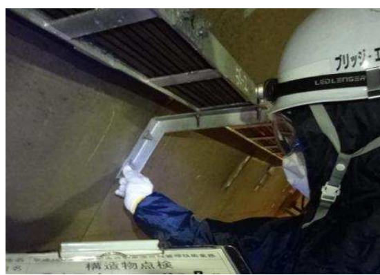
点検状況（電気通信施設）
