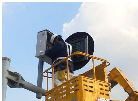
点検状況（電気通信施設）
