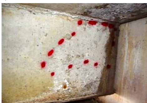
粒江高架橋 主桁、張り出し床板部に浮き 補修前
