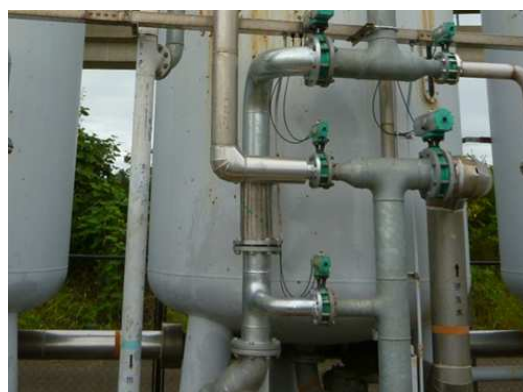
汚水処理設備ろ過タンク配管（補修後）
