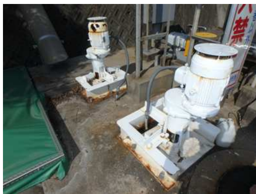
凍結防止設備用攪拌機（補修前）
