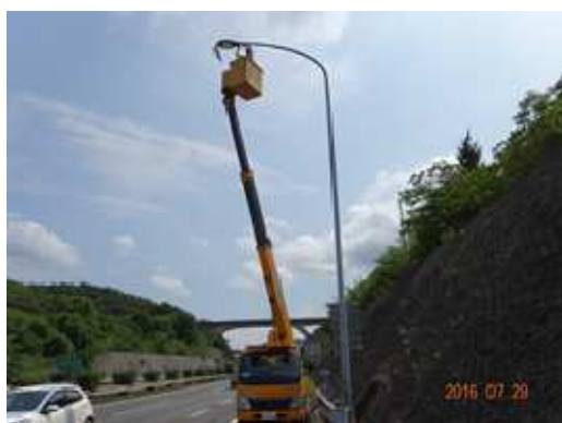
点検状況（電気通信施設）
