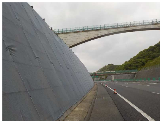
コンクリート片剥落対策
