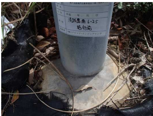
照明柱基部（補修前）
