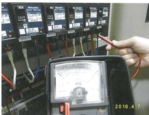
点検状況（電気通信施設）
