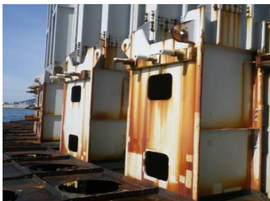
鋼製緩衝工(補修前)
