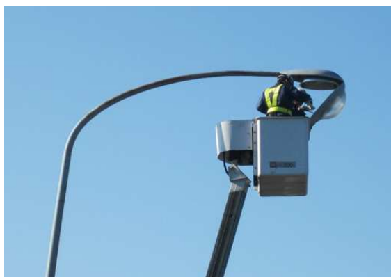
点検状況（電気通信施設）
