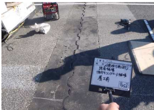
伸縮装置後打ちコンクリート(補修前)
