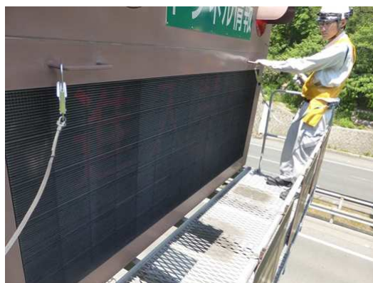
点検状況（電気通信施設）
