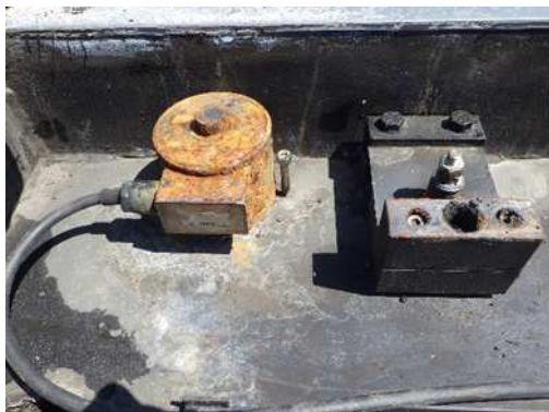
軸重計ロードセル (補修前)
