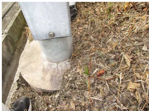
照明柱基部 (補修前)
