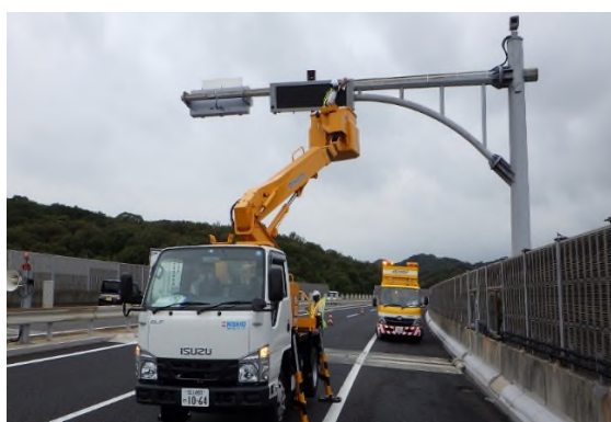
点検状況（電気通信施設）
