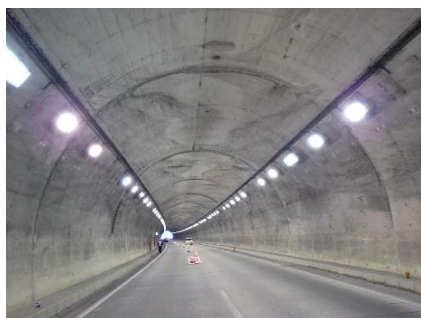
トンネルはく落対策（補修前）
