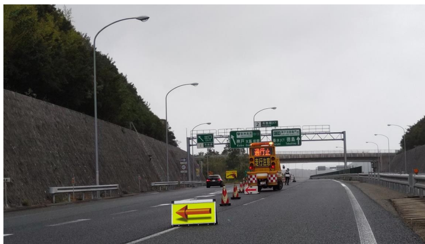
本線の通行止めの状況
