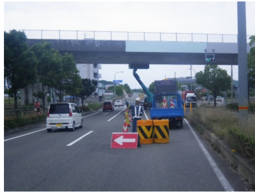
写真—4 阿方高架橋(施工中) ※ 国道を交通規制しての剥落防止工
