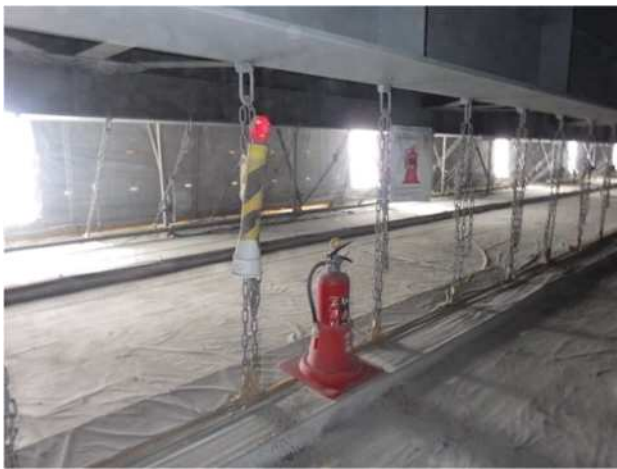
写真-3 消火器設置箇所点滅灯
