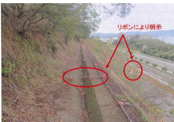
写真－５ 作業用通路危険箇所明示
