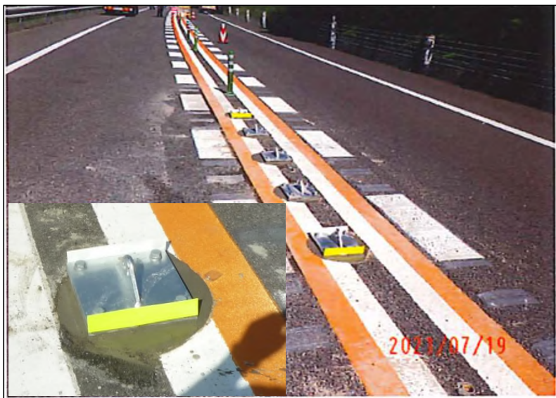
鋼管杭基礎末端の注意喚起対策
