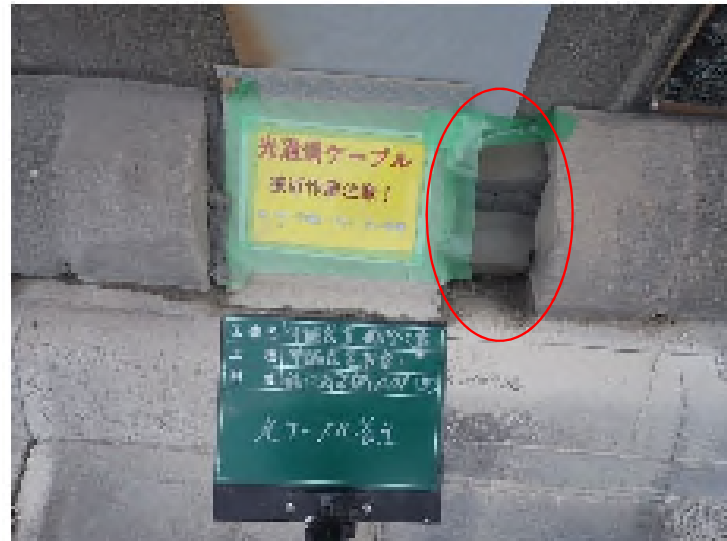
光通信ケーブルの露出している部分を ウレタンフォームで保護及び表示版を設置
