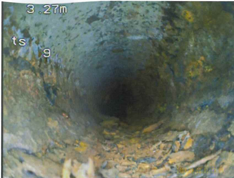
トイレ前 掃除口 横配管状況 浮きさび 有り
