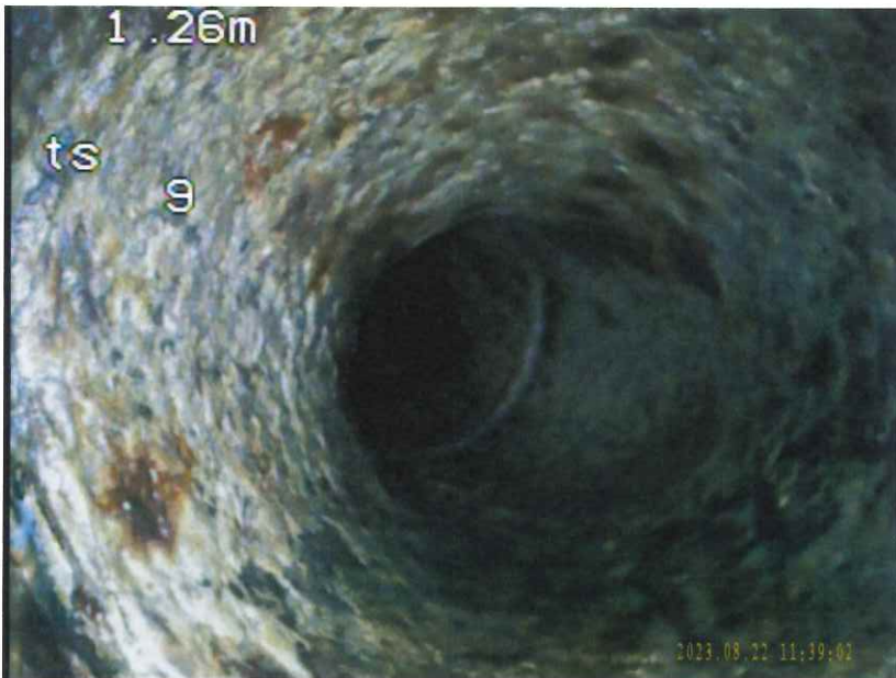
洗面所 掃除口 横配管状況 浮きさび 有り
