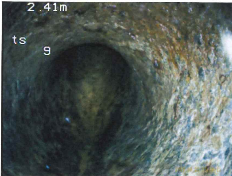
外部排水枡 横配管状況 浮きさび 有り
