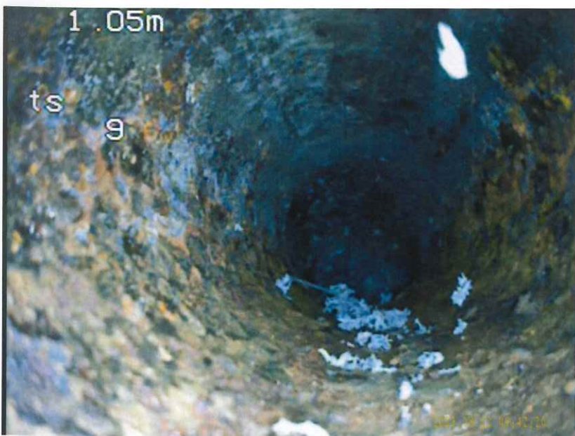
台所 掃除口 横配管状況 浮きさび 有り
