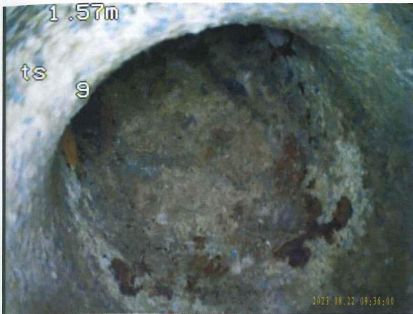
トイレ前 掃除口 横配管状況 浮きさび 有り
