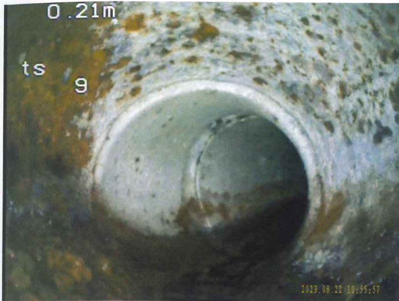
外部排水枥 横配管状況 浮きさび 有り
