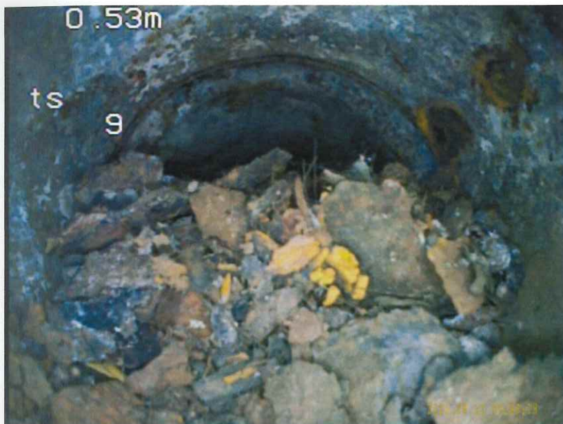
洗面所 掃除口 横配管状況 乾燥して配管内部附着 物がはく落
