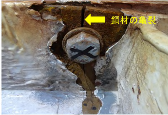
①伸縮装置の腐食状況（路面裏側）
