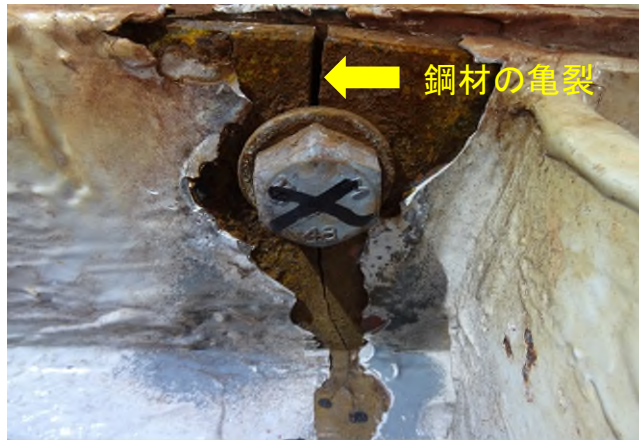
①伸縮装置の腐食状況（路面裏側）
