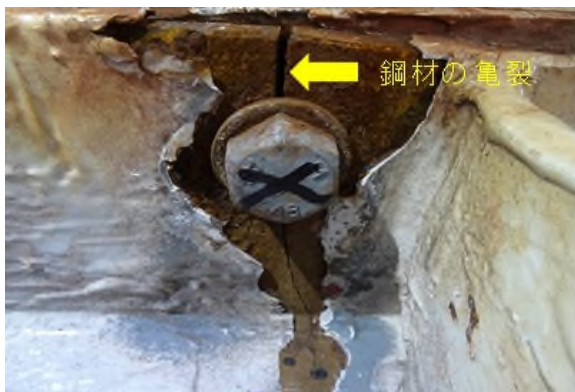
① 伸縮装置の腐食状況 (路面裏側)
