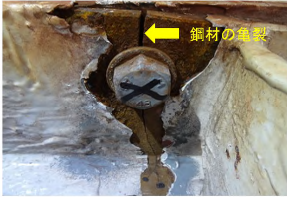
①伸縮装置の腐食状況（路面裏側）
