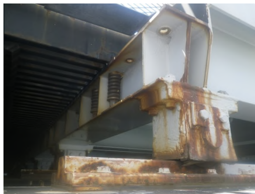
②大型伸縮装置の腐食状況
