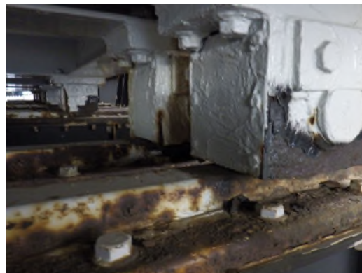
②大型伸縮装置の腐食状況
