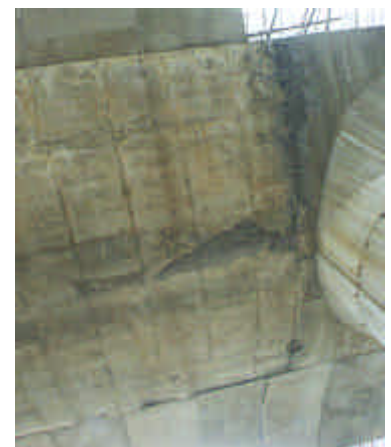
主桁の損傷状況 Breakage of main girder
